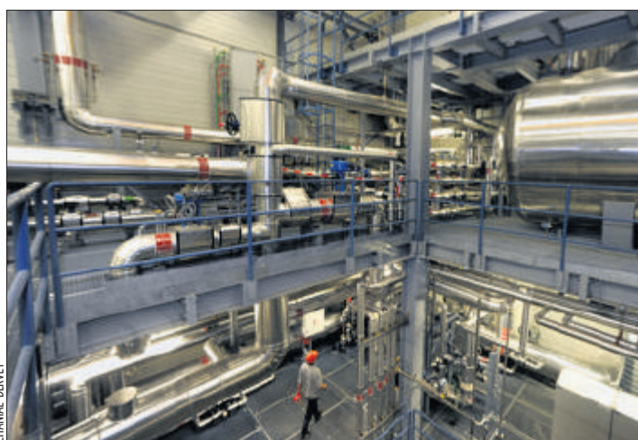
La centrale Monthel a été construite en vingt mois seulement. Le groupe Alpiq a investi 100 millions de francs dans ce projet.
